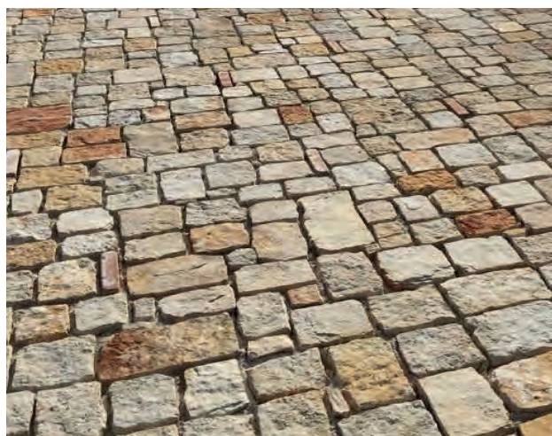
Pavimento in tranciato quadrato in pietra di Trani
